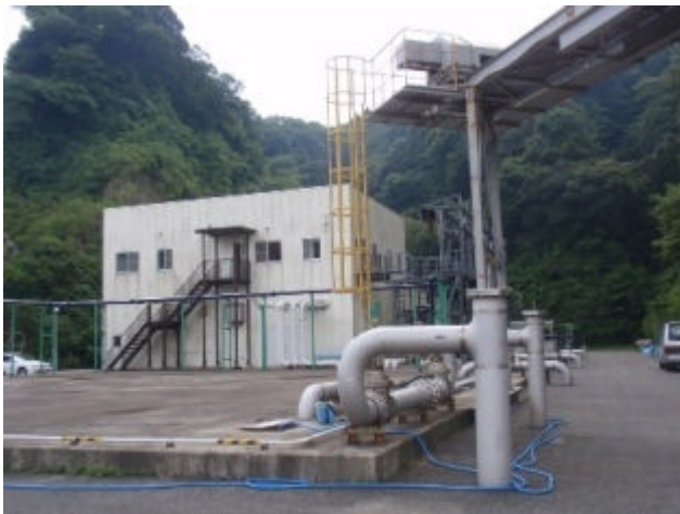
浸出水処理施設、設備の二重化等を図り安全性を高めています
